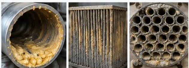
Zanesené potrubí Zanesené filtry Úsady na teplosměnných plochách / katalyzátoru
